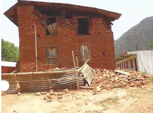
Schule, die durch das Erdbeben beschädigt wurde
